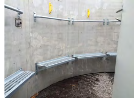
Stehpodest mit Handlauf
